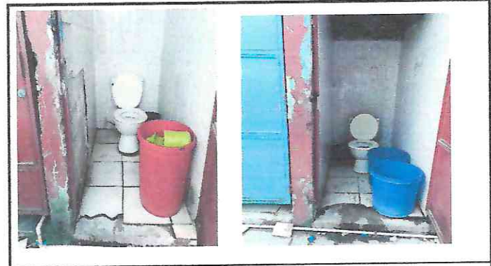
Foto 4: Inodoros y azulejo en mal estado.
