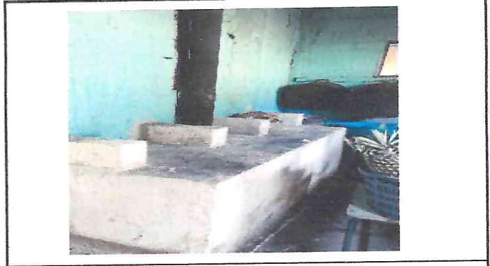
Foto 2: Estufa rural en mal estado, no adecuada
