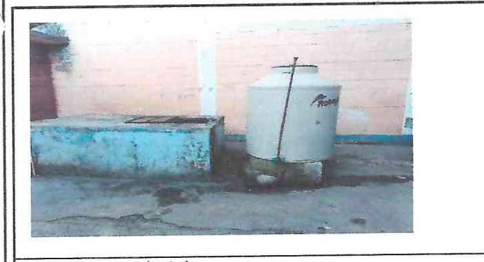
Foto 5: tínaco en mal estado.
