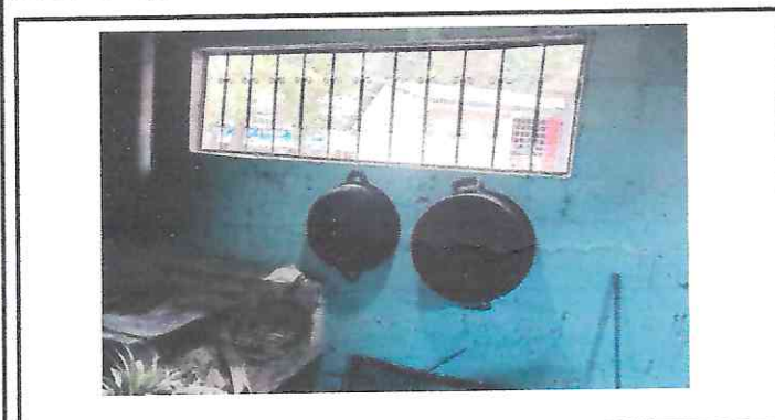
Foto 3: Balcon en mal estado
